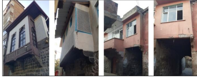
Şekil 4. Ziya Gökalp ve Abdal Dede Mahallesi'ndeki "Cumba"lar ile Sülüklü Sokak'taki "Kabaltı"daki Bazalt Taşı, Tuğla ve Ahşap Malzeme Kayıpları (2023)
