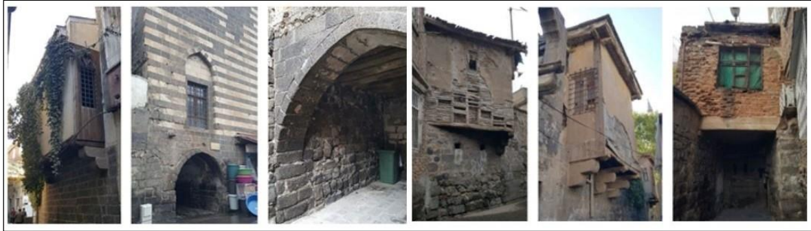
Şekil 3'a-f. "Cumba"lar ile "Kabaltı"lardaki Bazalt, Tuğla ve Ahşap Malzeme Kayıpları (2023)
